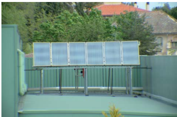
> Panell de captació solar.
