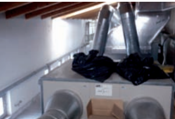
Bombes de calor (Inverter) de la Sala la Canal
