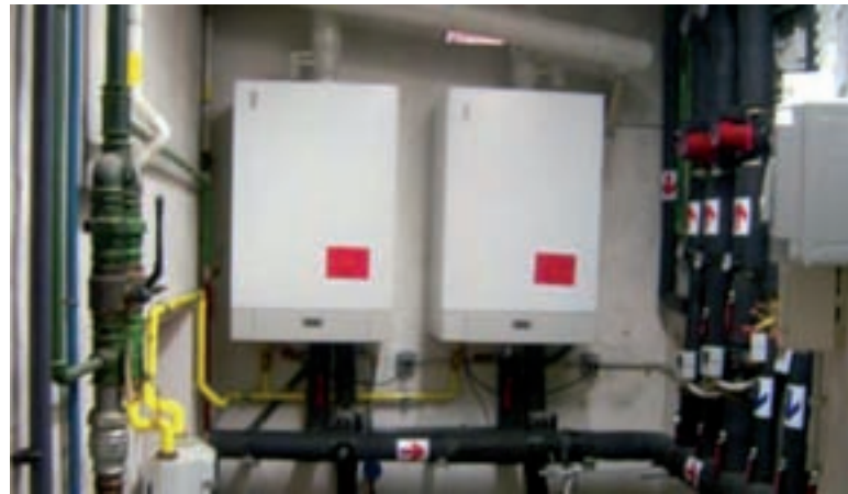
Adequació Calefacció Casal Can Codina
